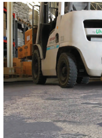
ผิวสีกร่อนจากโฟล์คลิฟท์ CORROSION FROM FORKLIFT
