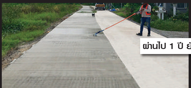
ถนน ต.บางเสร่ อ.สัตหีบ จ.ชลบุรี ติดตั้ง ม.ย. 2563
