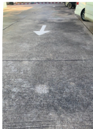
ผิวคอนกรีตที่เกิดราดำ BLACK MOLD SURFACE
