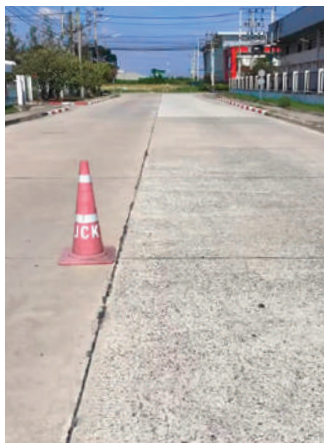
ผิวสีกร่อนจากฝนตก CORROSION FROM DRIVEN RAIN
