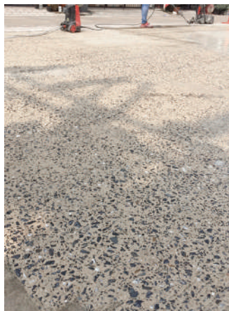
ผิวสีกร่อนจากล้อรถยนต์ CORROSION FROM WHEEL TRAFFIC
